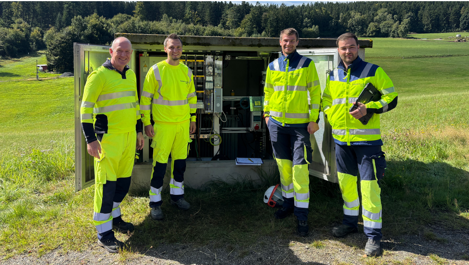
Machten sich vor Ort ein Bild von einer Retrofit ONS (v.l.n.r.): Peter Ketterl, Leiter Technik Ostbayern, Stefan Dobmeier, Leiter Bayernwerk Netz-Kundencenter in Weiden, sowie die beiden Servicetechniker Maximilian Zehent und Julian Bauer.
